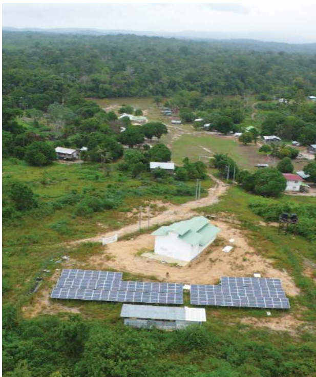
Centrale électrique hybride - Commune de Maripa-Soula
