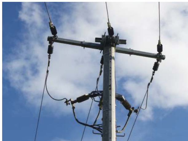
Réseaux d'extension électrique – commune de Papaïchton
